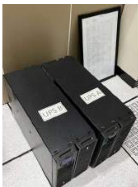
Gambar 3.2.5.1.4. Catu Daya Listrik Cadangan - Genset dan UPS
